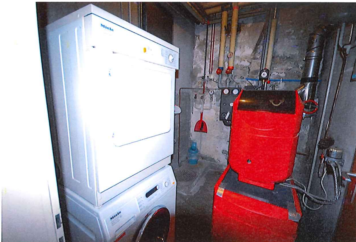
Local chauffage buanderie au rez-inférieur
