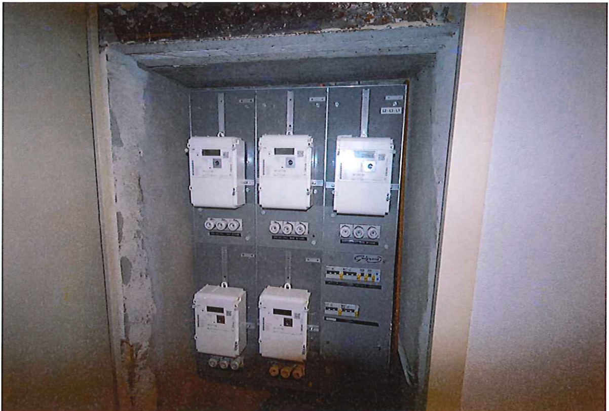
Compteurs électriques séparés
