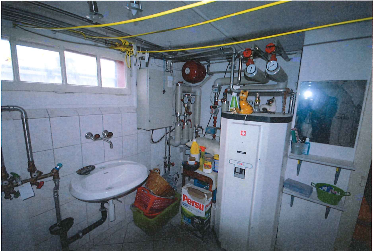
Local technique, buanderie au sous-sol
