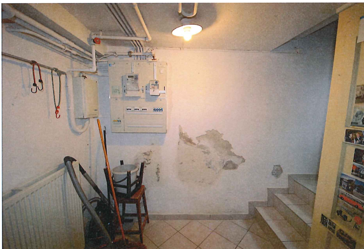
Hall de distribution au sous-sol avec tableau électrique et escalier
