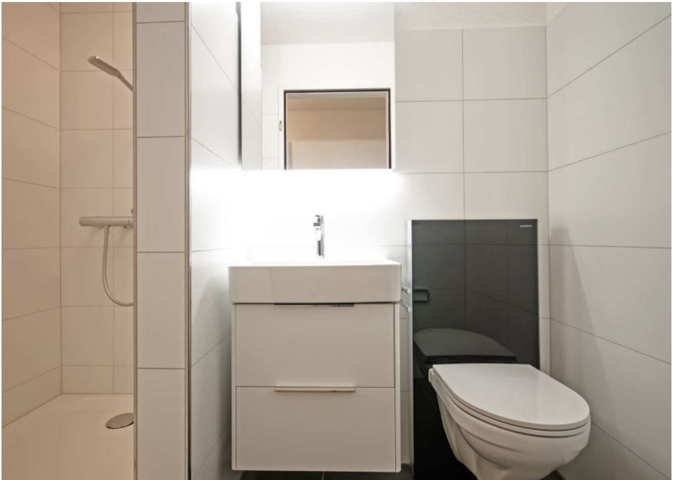
Separate Dusche/WC in hochwertiger Ausführung.
